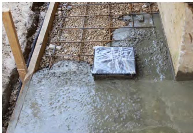
Рис.7. Заливка бетоном - предпоследний этап кладки отмостки. Останется только декорировать поверхность бетонной основы вокруг дома плиткой
